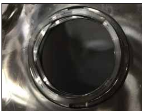
Εικόνα 56 - Τοποθετημένο ελατηριωτό παρέμβυσμα
