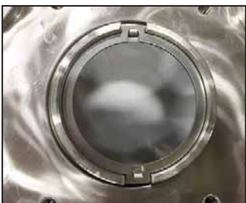
Figura 84 - Anel de acionamento instalado
